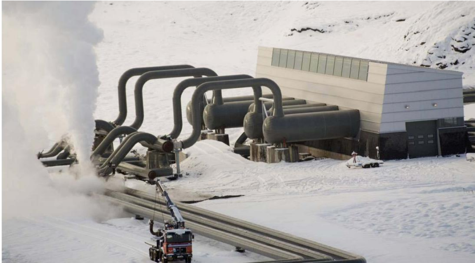
Mynd 12.10 Skiljustöð við Hellisheiðarvirkjun.
